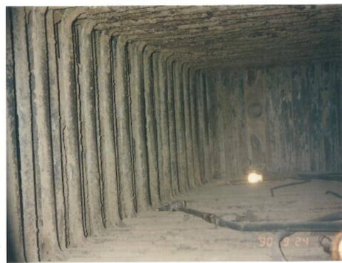
灰がこびりついたボイラー内の水管
